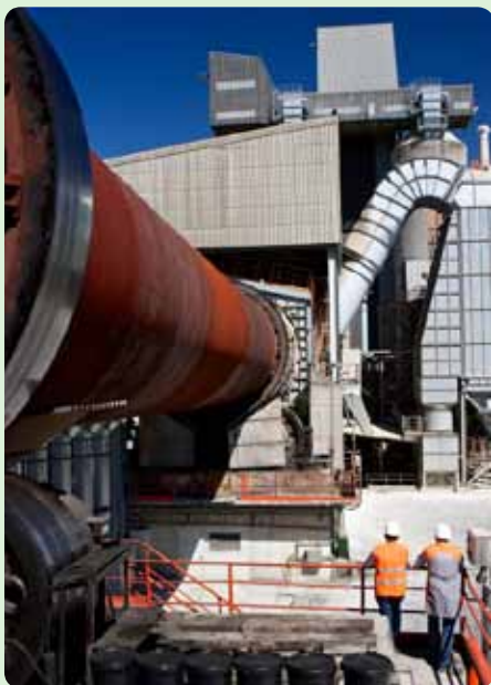
Slika 1: Rotacijska peč za proizvodnjo cementnega klinkerja.
