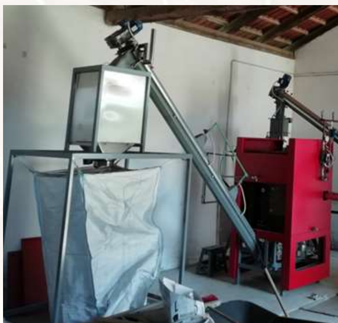
Slika 5: Transportni sistem za biooglje in skladiščenje proizvedenega biooglja.
