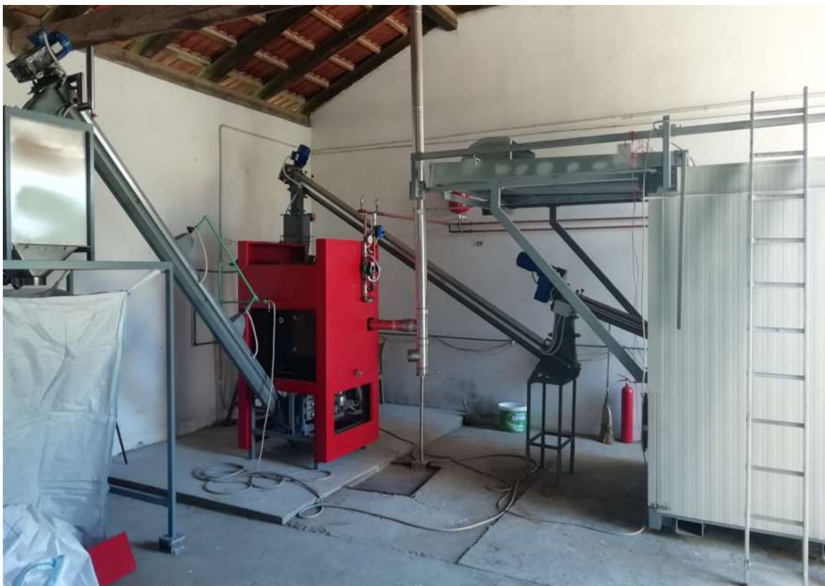
Slika 11: Pirolizna naprava KOPI postavljena na kmetiji Vogrinec v Skorbi
